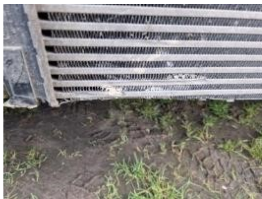
Sl. 15. Bliže prikazano oštećenje
