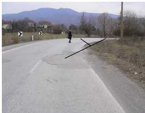
Sl 3 Oštećenje na kolovozu koje je uslovalo destabilizaciju motornog vozila ( nakon popravke )
